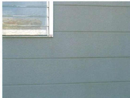
石綿セメント・サイディングの例
