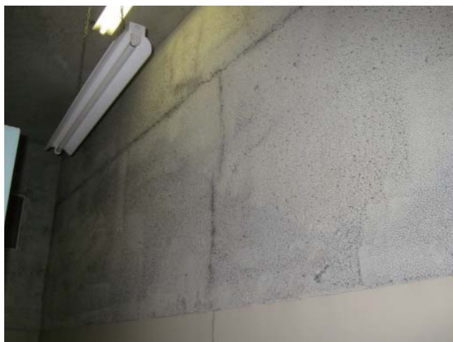
○空調等機械室
