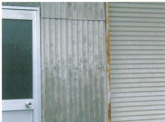
石綿スレート（波形）の例
