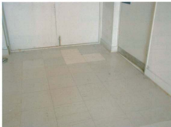
ビニール床タイル（石綿含有）の例
